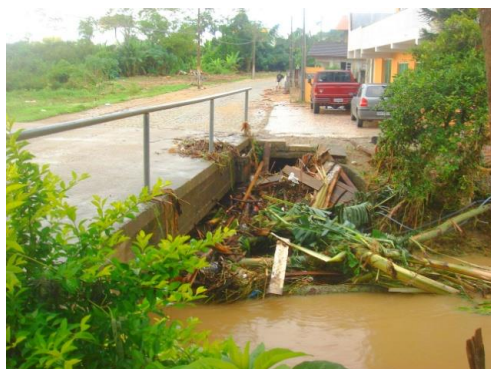
Figura 28: Detalhe do entulho acumulado na ponte quando ocorre uma chuva forte.
