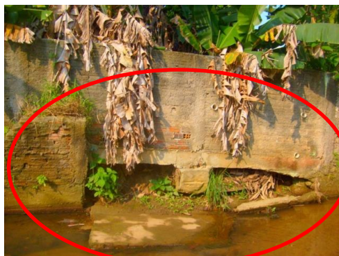
Figura 34: Exemplo da situação em que um muro é construído sobre os entulhos do muro anterior (detalhe).
