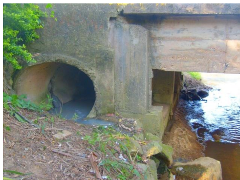
Figura 30: Foco de contaminação por esgoto na rua mais movimentada do bairro.
