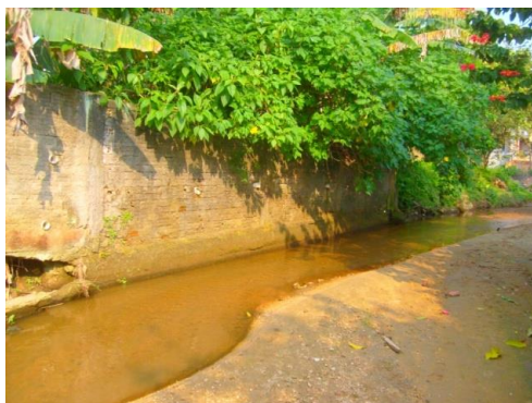
Figura 33: Poucos metros à frente outro muro no leito do rio.
