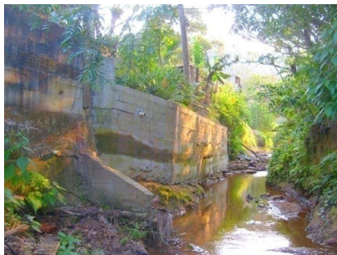
Figura 51: Em contraste com as outras situações aqui nota-se um reforço na estrutura do muro.
