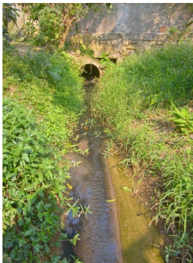
Figura 38: Vala com esgoto de várias casas.
