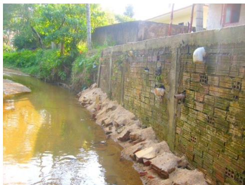
Figura 32: Muro construído sobre aterro com entulhos no leito do rio.
