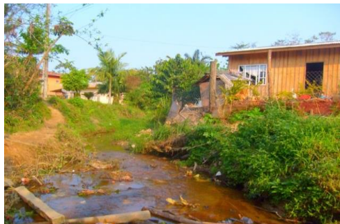
Figura 44: Ocupação da APP e uma tentativa de contenção da margem com materiais pouco resistentes que acabam por serem carregados pelas águas.
