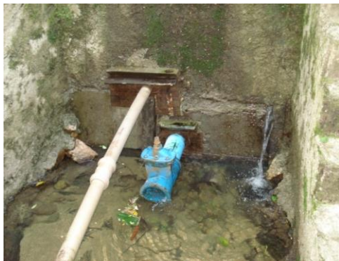
Figura 19: Equipamentos abandonados no leito do rio.
