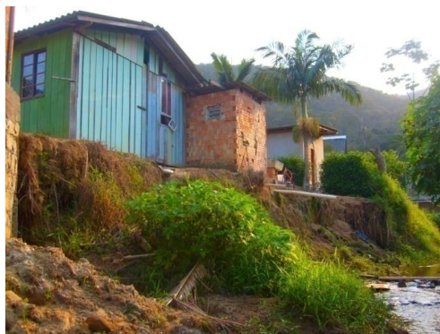
Figura 49: Detalhe do banheiro construído à beira do rio com cano de esgoto despejando no rio.
