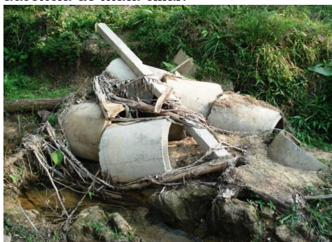
Figura 72: Grande quantidade de entulhos no leito do rio.
