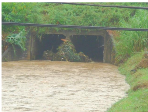
Figura 29: Acúmulo de entulho na galeria de passagem pela BR 101, restos de poda e árvores arrastadas ao longo de todo o rio, somam-se aos resíduos e esgoto das casas.
