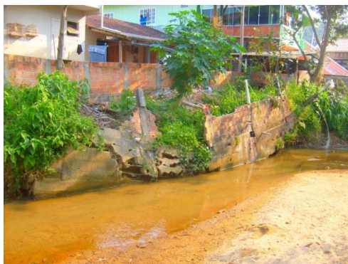
Figura 35: Aqui um muro foi construído logo atrás do outro muro que está se desprendendo.
