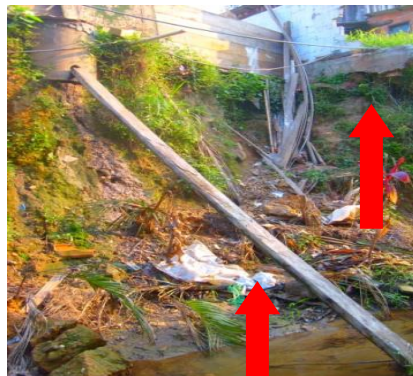
Figura 57: Destaca-se o muro que já desabou dentro do rio após ter sua base completamente erodida. A manilha que faz a função de fossa está escorada por uma madeira fixada no leito do rio.
