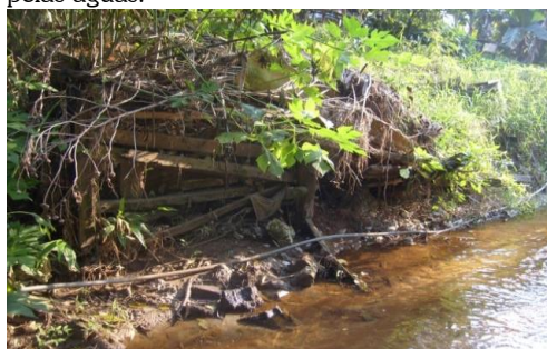
Figura 46: Precariedade de materiais na tentativa de contenção da margem do rio.
