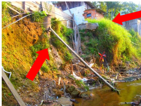
Figura 56: Situação que causou perplexidade na equipe. A erosão chegou até onde estava enterrada uma manilha que armazena as fezes até serem despejadas no rio.
