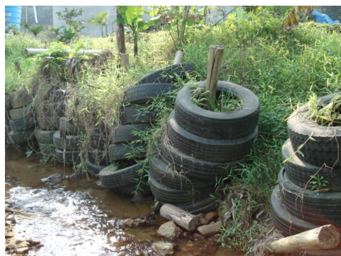
Figura 64: Barreira de pneus com estruturas de madeira apodrecidas pela umidade do rio
