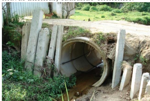
Figura 71: Estacas de concreto sem sapatas, improvisadas para conter a erosão.
